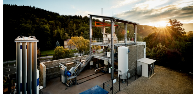
Überblick über die aktuelle Konfiguration der Demonstrationsanlage zum Wasserstoffplasma-Schmelzreduktionsprozess (copyright voestalpine Stahl Donawitz GmbH)
